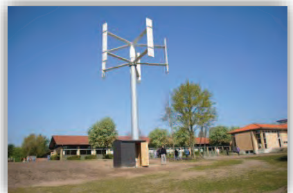
Éolienne Darrieus de 6 kW
