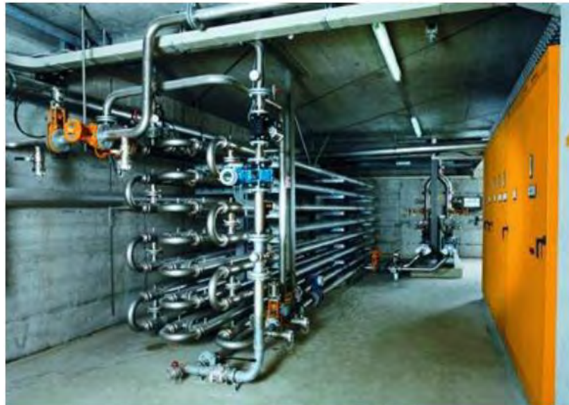
Figure 191 : Echangeur tubulaire en sortie de STEP (Lyonnaise des Eaux, ISTINOX, ANTEA)
